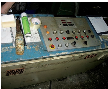
Abb. 4: Alte Steuerung einer Spaltmaschine
