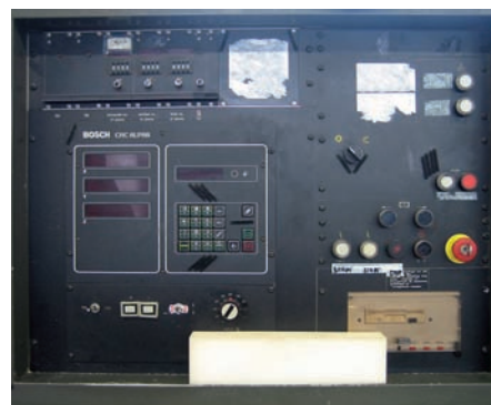
Abb. 6: Alte Steuerung einer CNC-Konturenschneidemaschine
