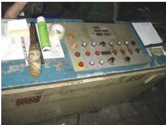
Abbildung 5: Alte Steuerung einer Spaltmaschine Quelle: Eigene Aufnahme.
